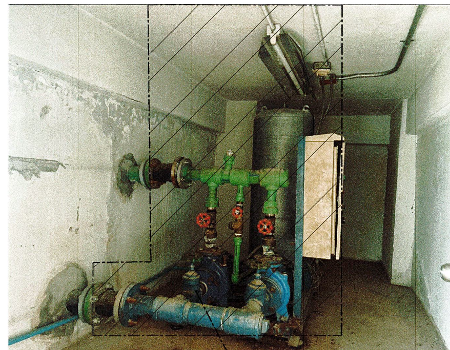
ระบบปั๊มน้ำ, วาล์ว, อุปกรณ์ประกอบเปลี่ยนใช้ของใหม่
